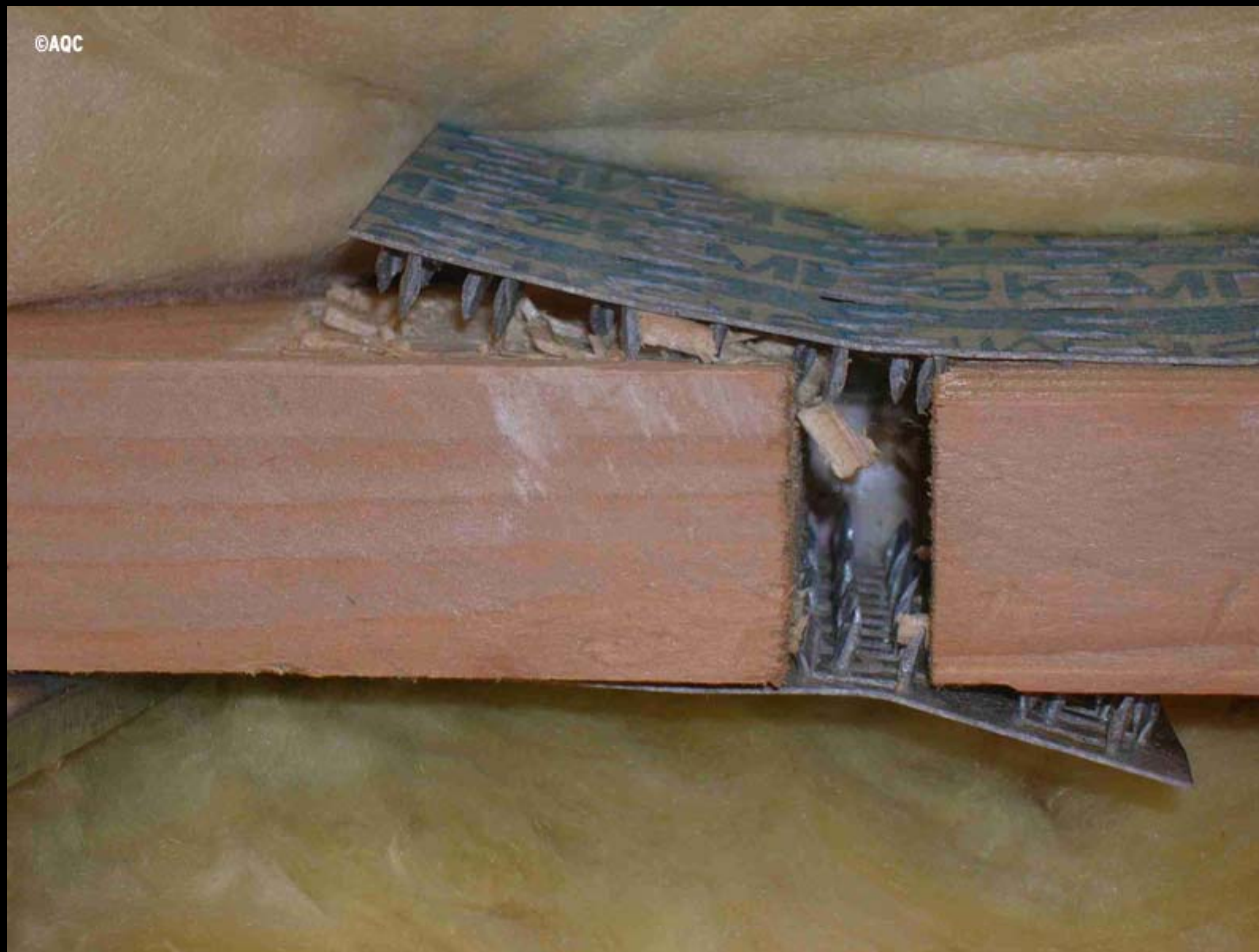
Charpente en fermettes, arrachement de connecteurs
