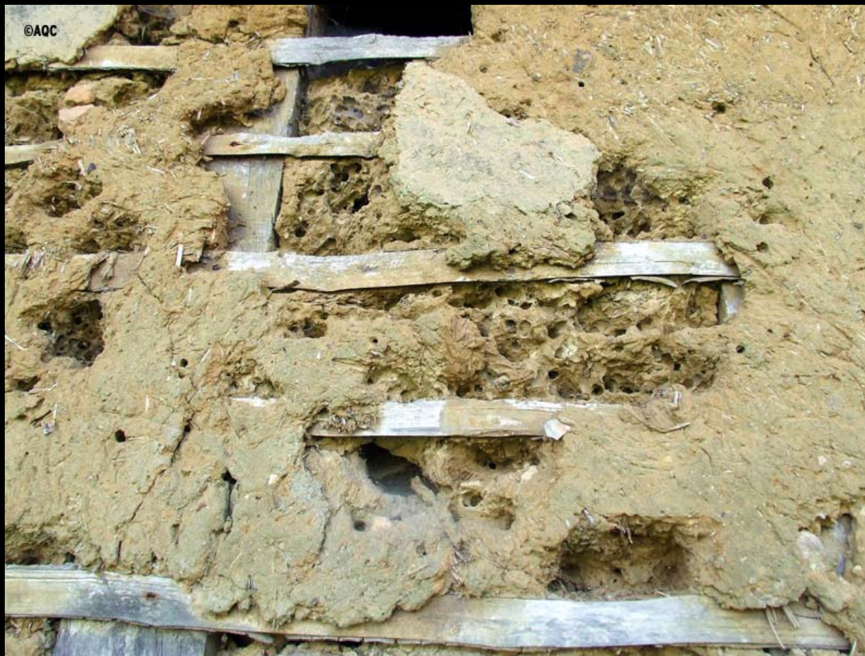
Détérioration du torchis d'un mur à pans de bois
