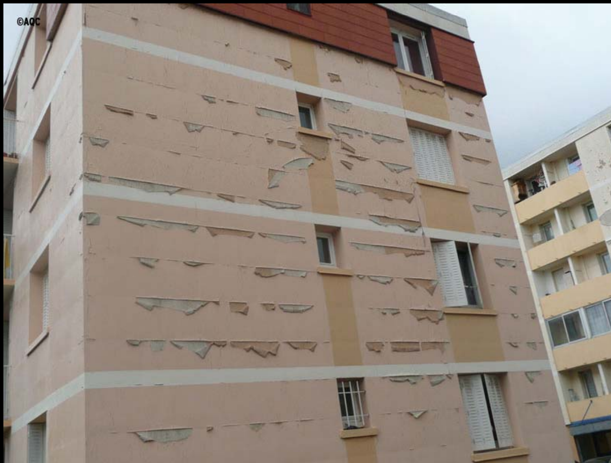
Maladie de peau d'un revêtement de façade
